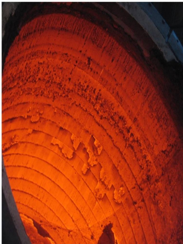
Figure 7 - Exemples de fissures et ruptures de briques.
