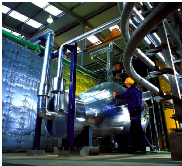
Figure 4 - Cuve d'oxydation par l'eau supercritique
